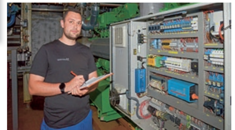
Alex Umnuß vertieft sich in die technischen Geheimnisse des Blockheizkraftwerks. Fotos (2): SPREE-PR/Krone
