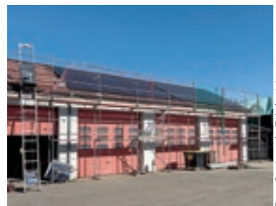
Die PV-Module sind montiert, jetzt kann die Sonne Energie liefern. Foto: Stadtwerke Zehdenick
