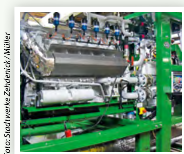
„Grüne“ Fernwärme für Zehdenick – erzeugt von zwei Biogasmotoren.
