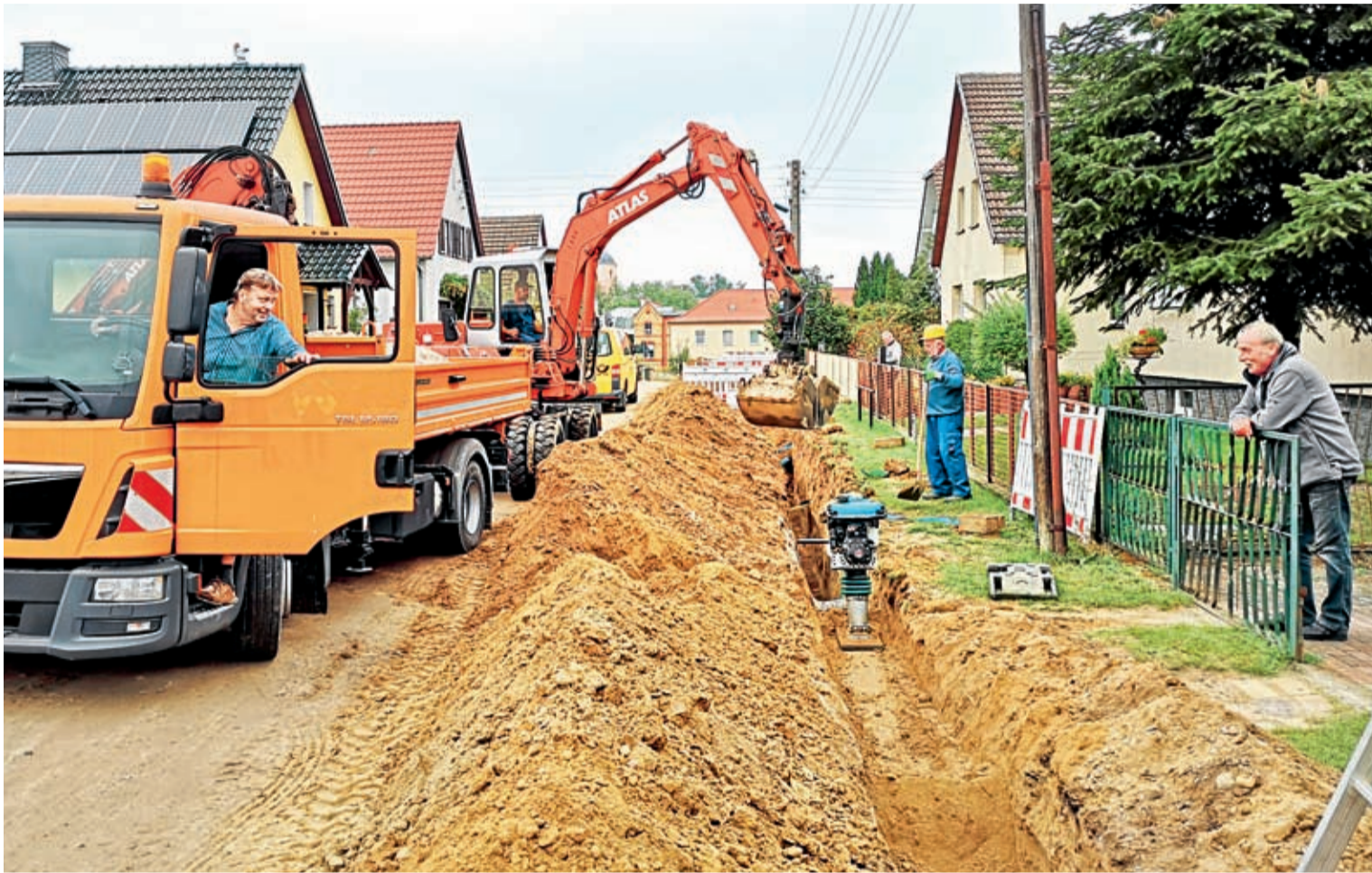
Die Anwohner im Amselweg haben allen Grund zur Freude: Stadtwerke-Trinkwassermeister Peter Radtke (im Lkw) und seine Bereichs-Kollegen haben unter anderem dafür gesorgt, dass die alten Leitungen gegen neue getauscht wurden.
